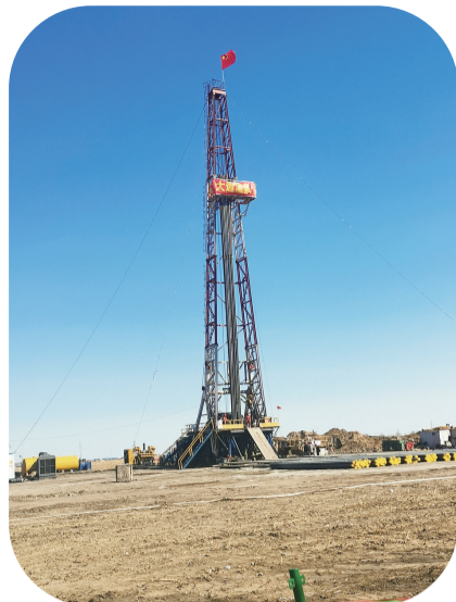
为打造乾安县生态旅游品牌,实现“千万游客入乾安”的旅游发展目标,乾安县大遐畜牧场积极开发温泉生态旅游度假区及康养中心建设项目,该项目是稻语花乡公园旅游公司的一个延伸项目。近日康养中心建设项目的温泉钻井工程正式启动,预计5月1日前完工。 王殿海/摄
